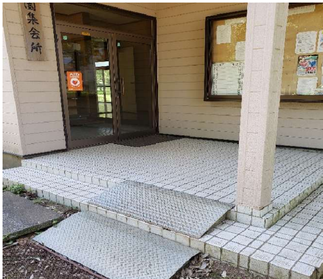
現在の集会所入口 段差解消のため鉄板を置いている
